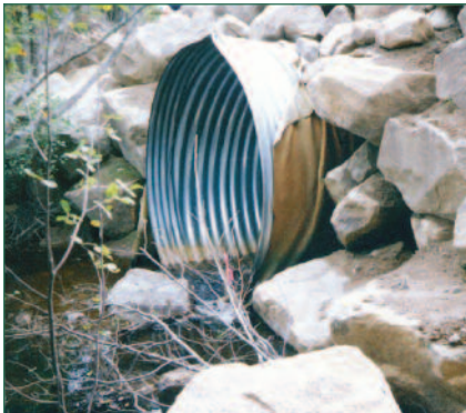
Les extrémités des ponceaux peuvent être aménagées en saillie du remblai, biseautées ou munies de murs de soutènement.
